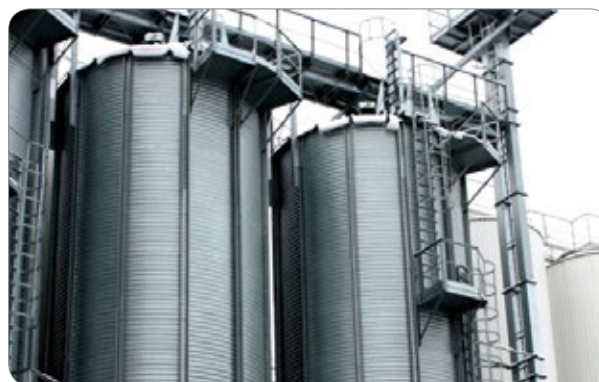
Завод «Перша приватна броварня», г. Львов, Украина
